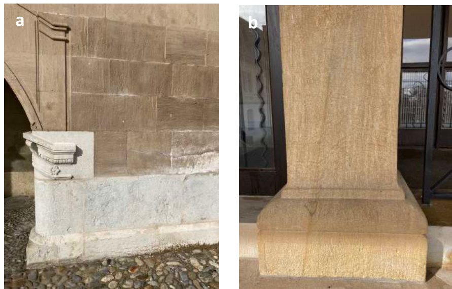
Figure 36: détails de la rampe et de l'entrée du bâtiment central; a: transition Calcaire blanc /Molasse (mauvaise restauration), b: pilier en calcaire jaune (probablement une roche calcaire de Neuchâtel ?).
