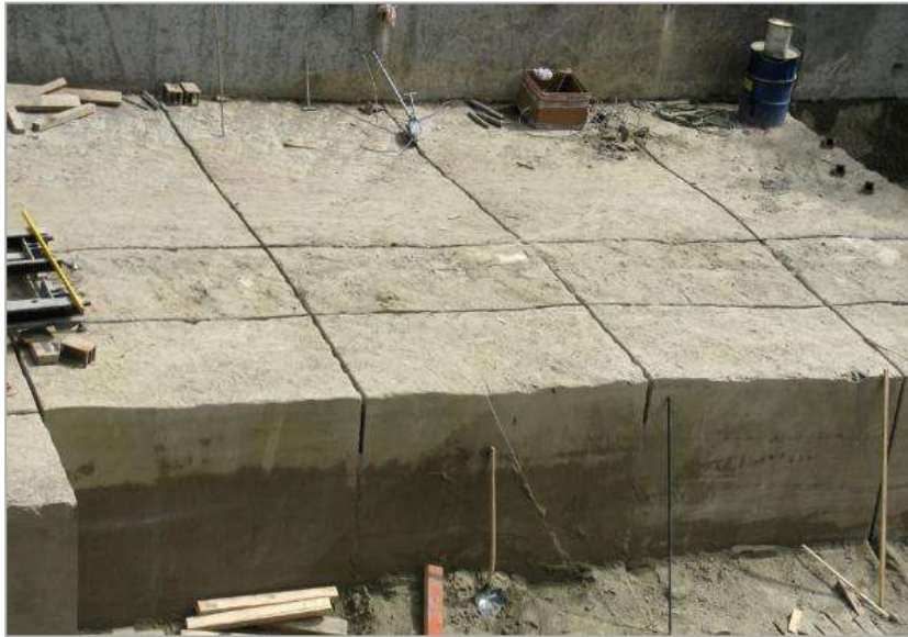
Figure 38: exploitation de Molasse rouge dans les Conservatoire et jardin botaniques en 2010 ( https://www.mellofilssa.ch/portfolio/exploitation-dune-carriere-de-molasse-du-lac/ ).
